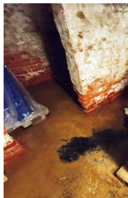
2.2.2 / Abb. 1: Wassereintrich im Keller mit unbekannten Verschmutzungen
